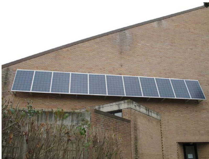
Figura 24 - Esempio di installazione non idonea alla classificazione dell'impianto fotovoltaico nella categoria "su edifici" – Motivazione: la struttura collegata non sottende superfici trasparenti
