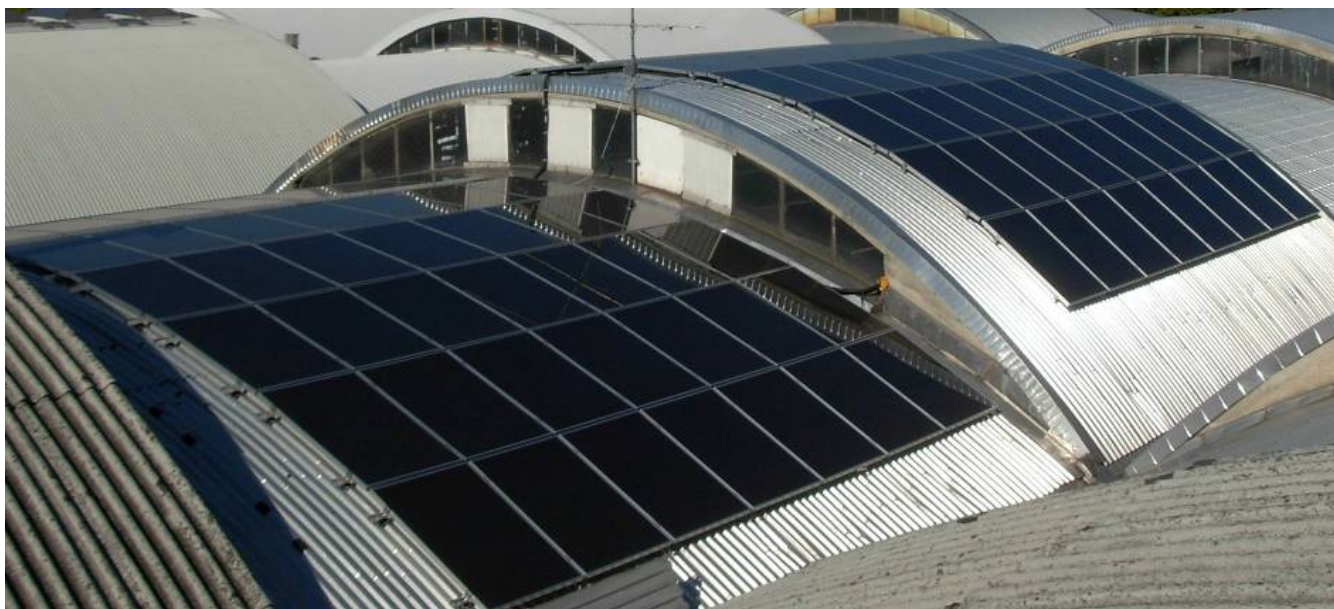
Fig.14 – Esempio di installazione idonea alla classificazione dell’impianto fotovoltaico nella categoria “su edifici” in caso di installazione su una superficie di copertura curva
